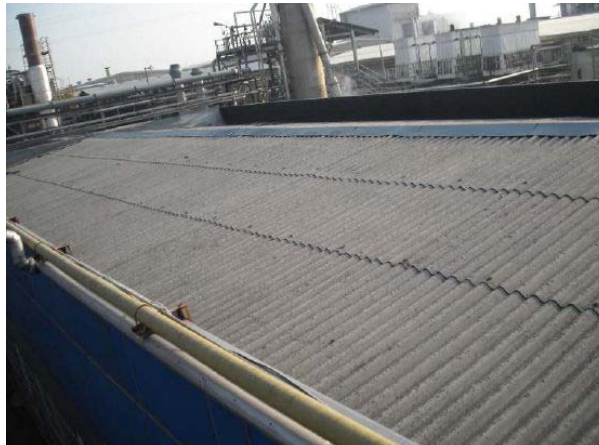
Figura 3.5 – Stato di conservazione della copertura della pressa CPL
